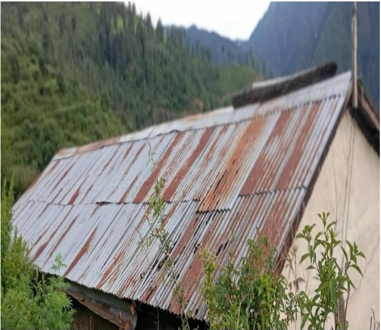
Altes und beschädigtes Schuldach.
